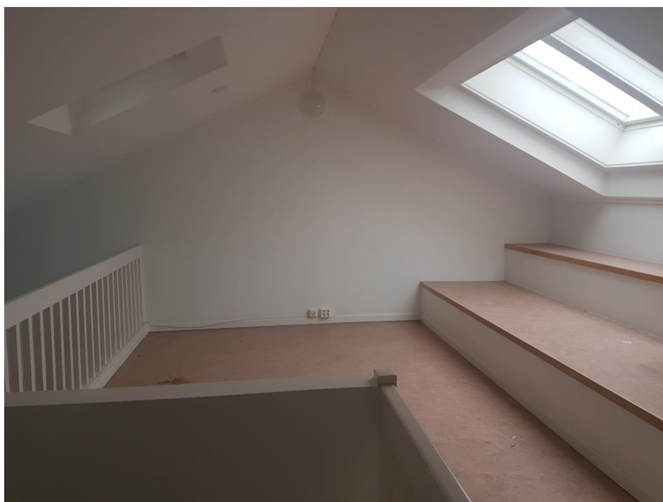
Dagens «amfi» på hems som skjuler ventilasjonsrør
