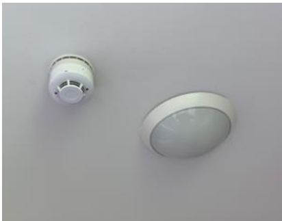
Eksisterende belysning i soverom som skal demonteres og remonteres.
